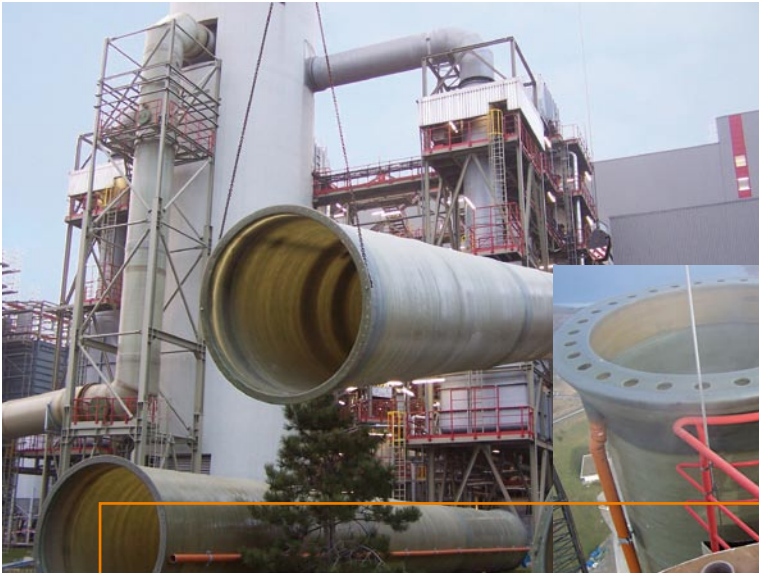
Braunschweigische Kohlenbergwerke AG, Kraftwerk Buschhaus: Die Rauchgasentschwefelungsanlage der Müllverbrennung arbeitet mit einem GFK-Kamin von Reich-Tank.
