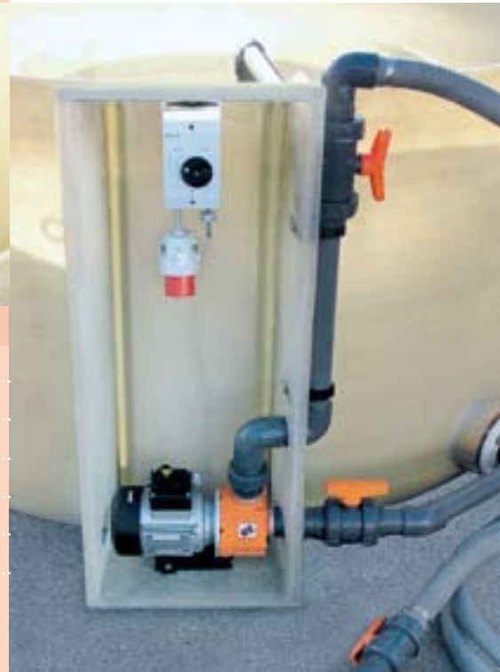
Anlagensteuerung des Solmatic S7
