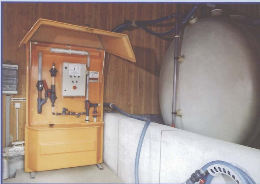
Misch- und Auftankstation Solmix
