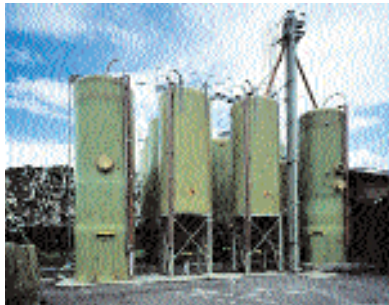
Soleerzeugeranlage für NaCl-Sole mit Förderanlage und Silozsilo
