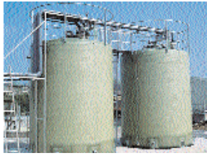
Doppelwandige Flachbodenbehälter für FeCl 3 in einem Klärwerk
