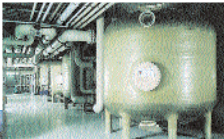
Filterbehälteranlage in einem Schwimmbad
